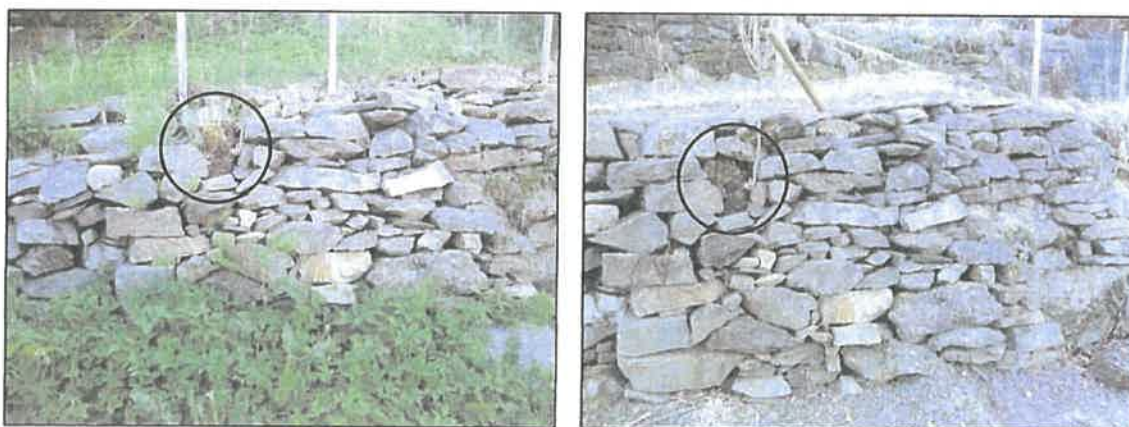
Figur 4. Mur, eller ein stabla røys, på nedsida av gangvegen mellom Tyssevegen 222 og 230. Det er ein trerot i muren (svart sirkel). Muren skal ha blitt bygd opp igjen etter at den gjekk i brot for nokre år sida. Det kan sjå ut som om muren manglar fot, har ingen struktur eller sjikt, ingen forband og det er brukt for små stein, og vil truleg ikkje tåla ein trafikklast.
