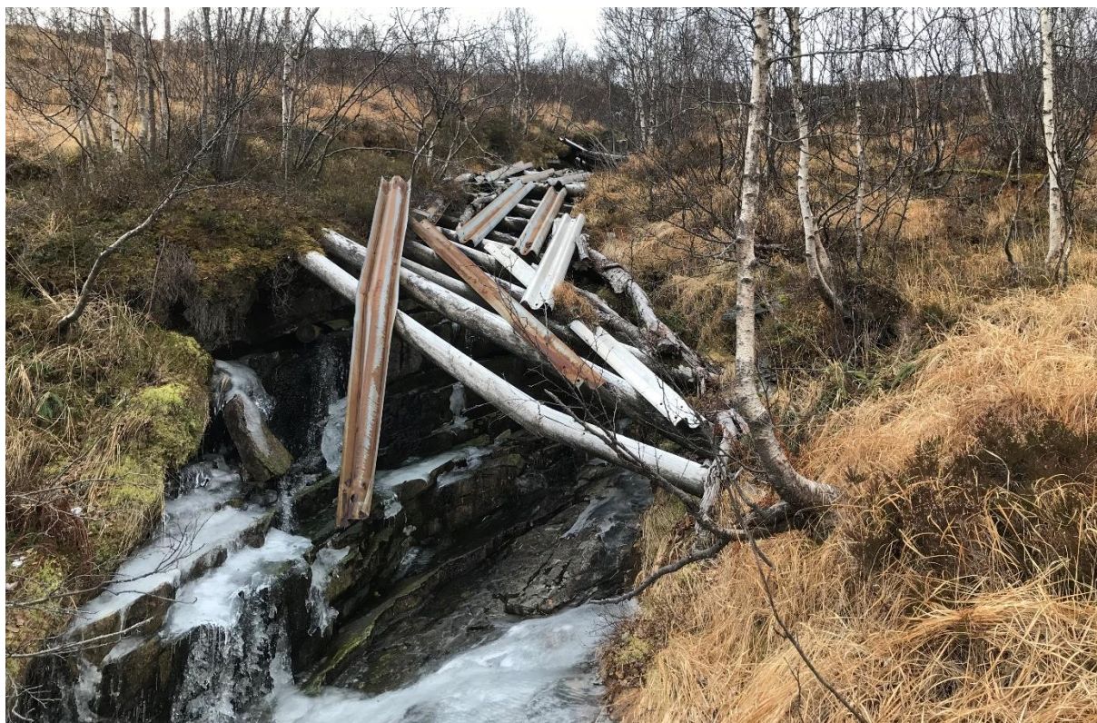
Figur 9: Foto av delvis øydelagd brukonstruksjon (Den øvste brua avmerkt i Figur 6).
