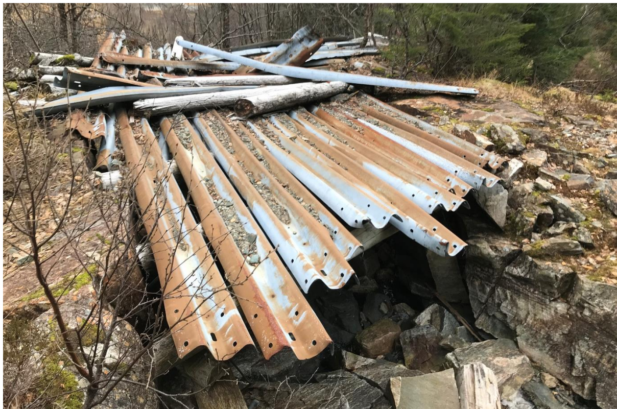
Figur 8: Foto av delvis øydelagt brukonstruksjon (Den niste brua avmerkt i Figur 6).
